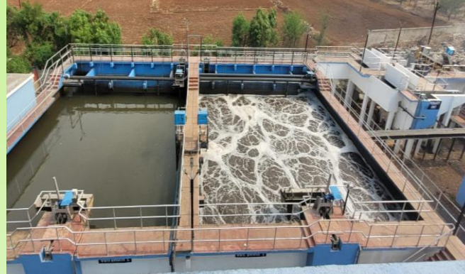
AMRUT - 4 MLD STP
